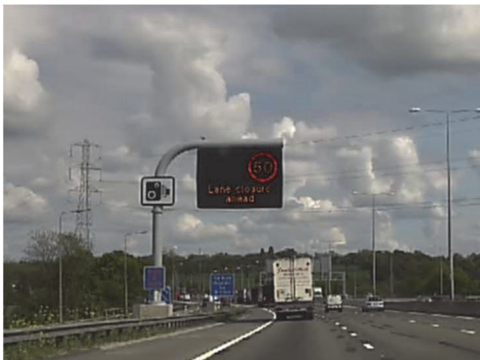
▲ 情報板は速度規制と車線閉鎖を表示
