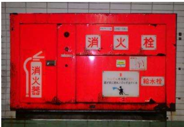
《従前の消火栓》
