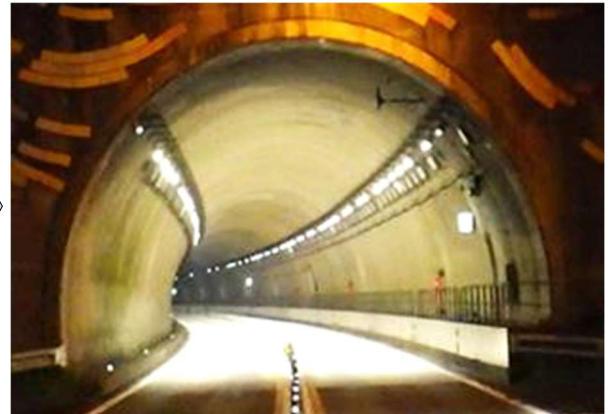
《更新後のLED照明》
