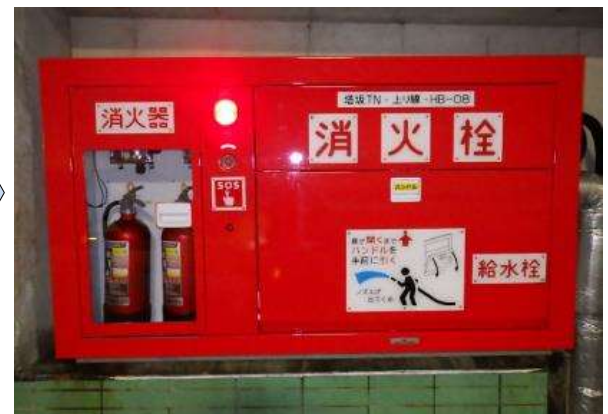
《更新後の消火栓》
