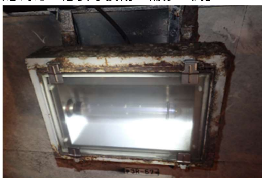
《トンネル照明の緊急補修（補修前）》
