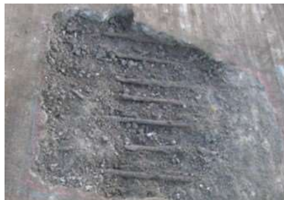
《床版上面のコンクリート土砂化》
