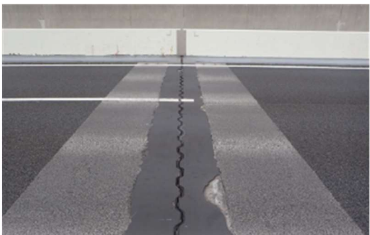
《伸縮装置の損傷（補修前）》
