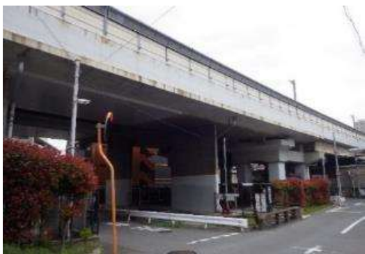
《橋梁上部工はく落対策（補修前）》
