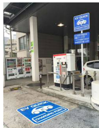
電気自動車用急速充電器
