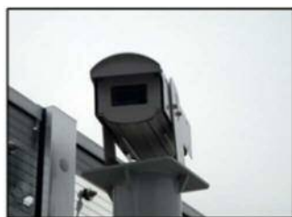
【改修前】固定式CCTV
