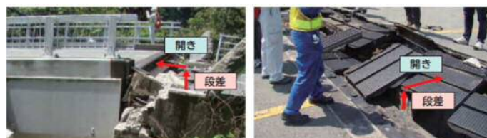
橋梁損傷事例
