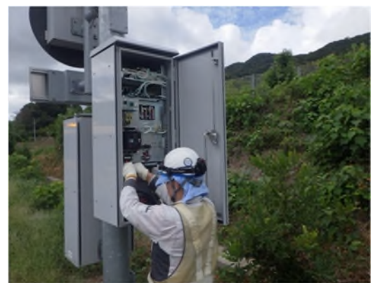
点検状況（電気通信施設）
