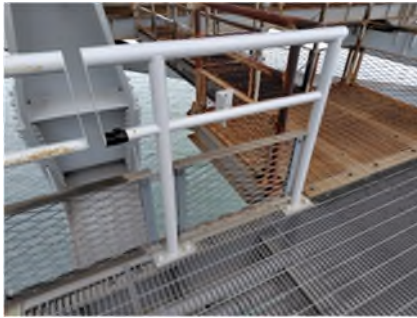
管理用通路（補修前）
