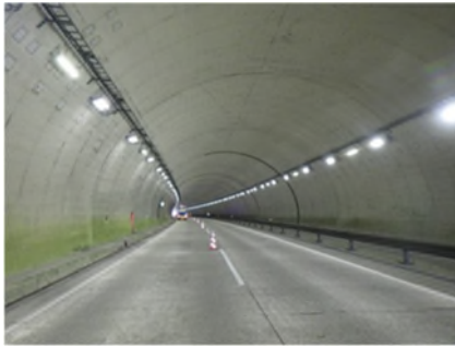
トンネルはく落対策（補修前）
