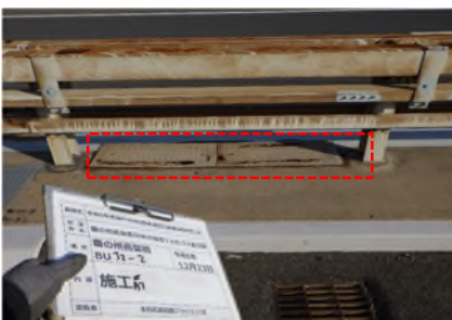
橋梁配線用プルボックス（補修前）
