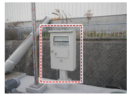
凍結防止設備制御盤（補修後）
