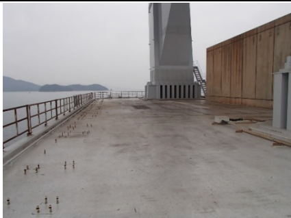
主塔基礎コンクリート塗装 (補修前)
