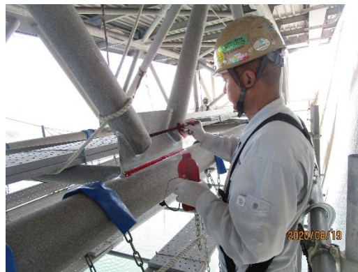
点検状況（機械設備）
