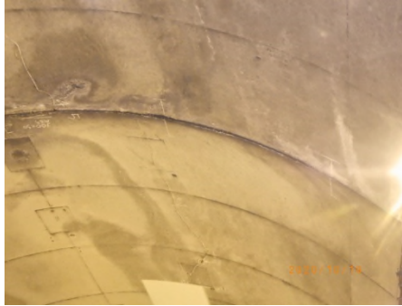
トンネルはく落対策(補修前)
