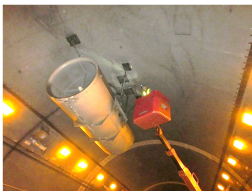
点検状況（機械設備）
