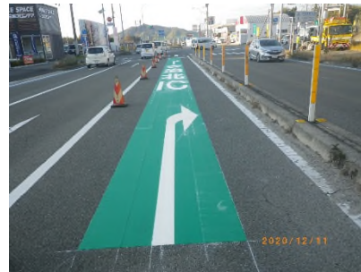
一般道誤進入対策 (路面標示)
