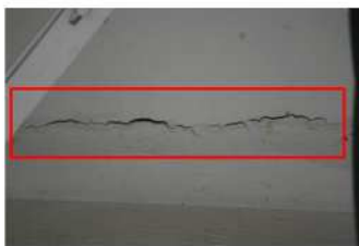
コンクリート桁の損傷 (ひび割れ)
