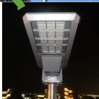
明かり部道路照明（LED）
