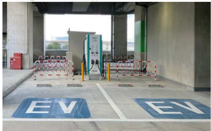
更新された充電器（泉大津PA〈海側〉）
