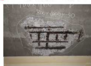
R C床版の損傷 (鉄筋露出)
