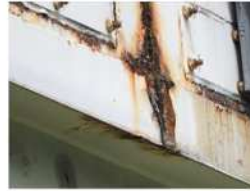
鋼製高欄部の損傷 (漏水による腐食)
