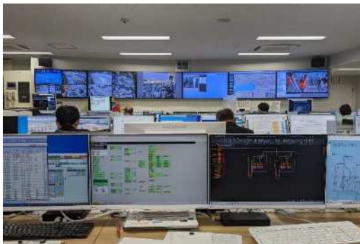
設備監視（大阪地区）
