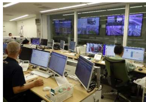
設備監視（兵庫地区）
