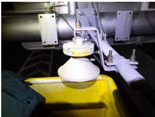
車両検知ヘッド補修前
