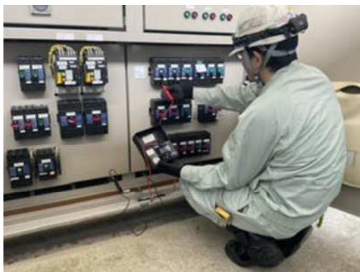
受配電設備点検
