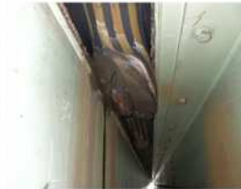
伸縮装置の損傷 (止水破損)
