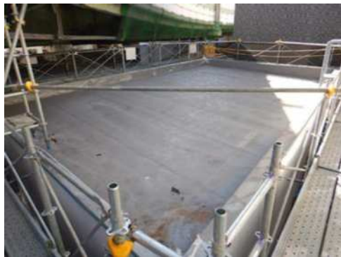
信濃橋倉庫屋上防水（補修前）
