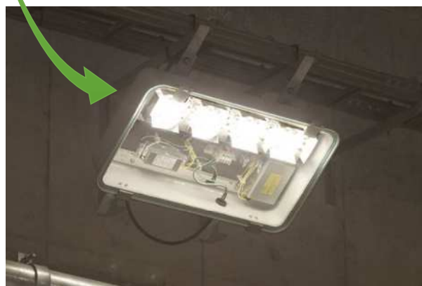
トンネル部道路照明（LED）
