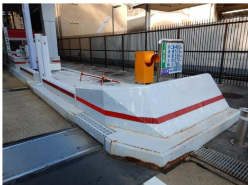
料金所アイランド損傷（補修前）
