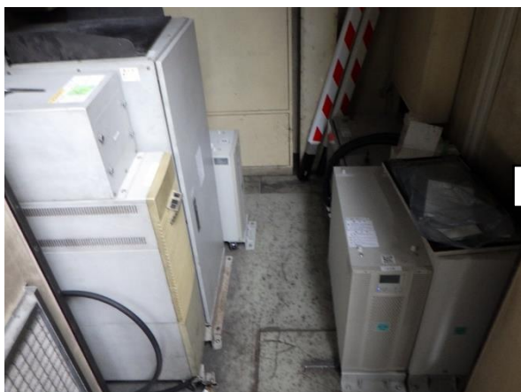
料金所無停電電源装置補修前
