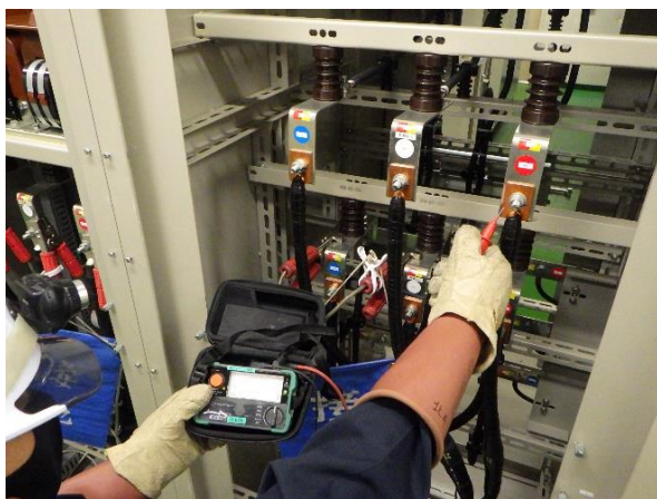
受配電設備点検
