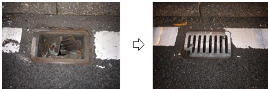
【速やかな対策が必要な変状の措置事例 橋梁排水施設の損傷(E1東名高速道路 小田急高架橋)】
