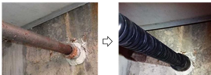
【速やかな対策が必要な変状の措置事例 電気・通信ケーブル用配管の破損(E8北陸自動車道)】
