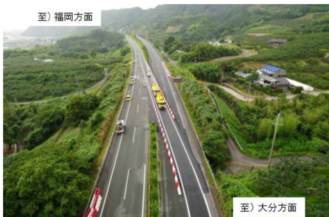
(渡り線の状況)
