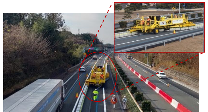
(移動式防護柵:ロードジッパーの運用状況)
