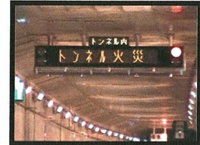
トンネル警報板
