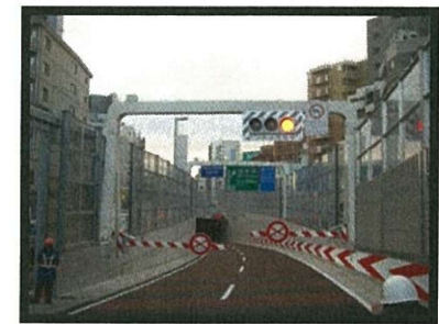
トンネル用信号機・遮断器
