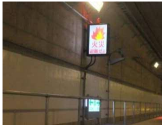
トンネル火災表示板 (非駐帯中間部)
