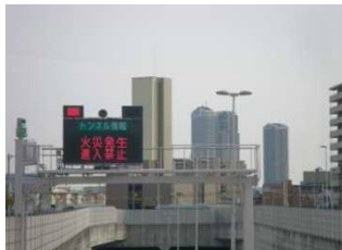
トンネル入口警報板
