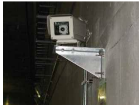
トンネル防災カメラ
