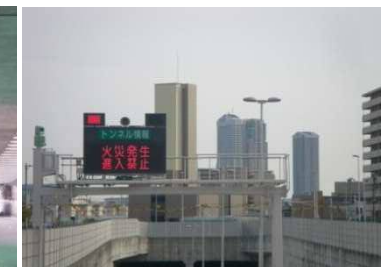
トンネル入口警報板
