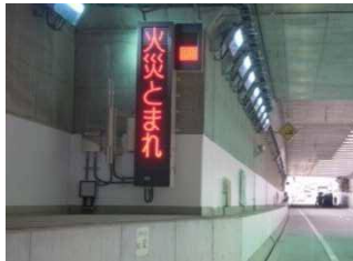
トンネル内警報板 (非常駐車帯部)
