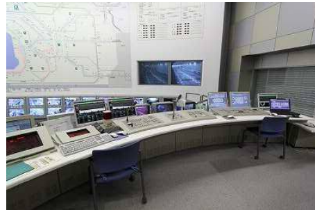
監視制御装置 (例: 朝潮橋管理所)
