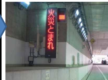
トンネル内警報板
