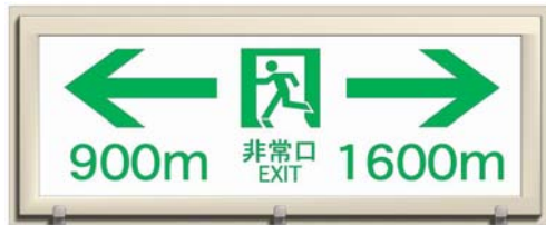
避難誘導表示板
