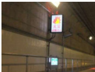
トンネル火災表示板 (非駐帯中間部)
