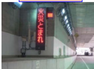
トンネル内警報板 (非駐帯部、出口分岐部)
