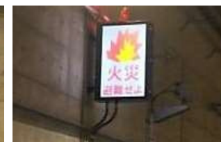
トンネル火災表示板
