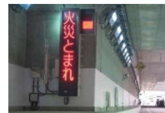
トンネル内警報板
