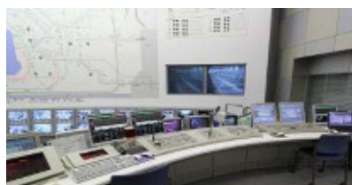
監視制御装置(朝潮橋管理所)
