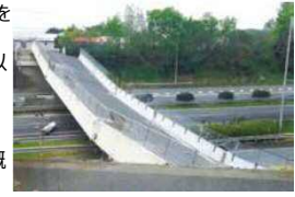
【熊本地震におけるロッキング橋脚を有する跨道橋落橋状況】
