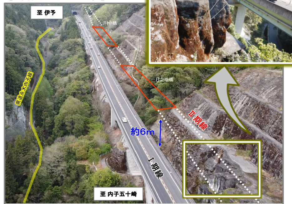
【き裂岩塊状況(切土部)】
