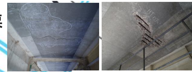
床版損傷状況
