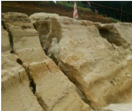
降雨後ののり面侵食状況
