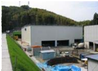
北九州JCT～苅田北九州空港IC施工時の防音ハウス
