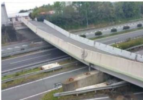
<府領第一橋(熊本県道)の落橋>
