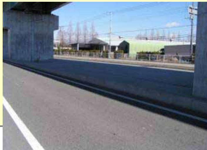
立入防止柵の省略状況
