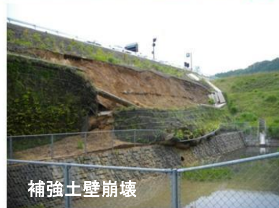
用地外のり面崩壊
