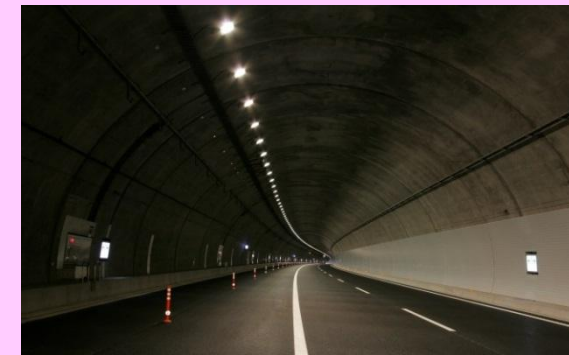
照明状況 (プロビーム照明方式:内側2車線運用)
