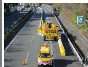
移動式防護柵移動状況
