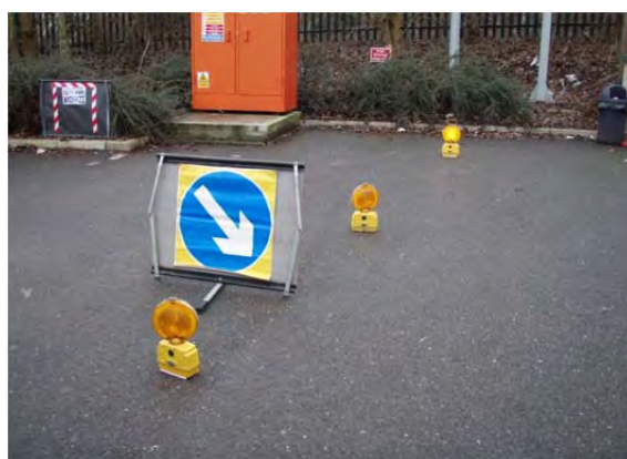
写真 2－4 規制機器の設置例
